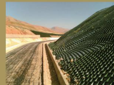
کنترل فرسایش کانالهای نیروگاه کوهرنگ
